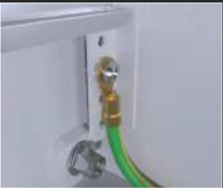
Earthing Cable p.: 71
