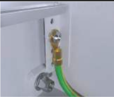
Earthing Cable p.: 71
