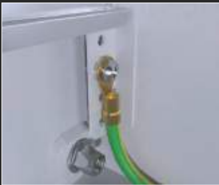
Earthing Cable p.: 71
